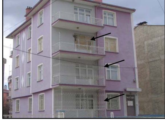
Resim 7. Emniyet gerekçesi ile balkonların demirle kapatılması (Korkmaz arşivinden).
