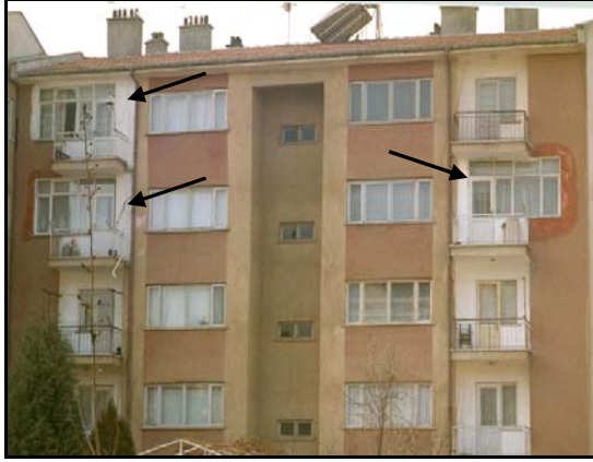
Resim 10. Mevcut pencerenin kullanıcı tarafından genişletilmesi (Korkmaz arşivinden).
