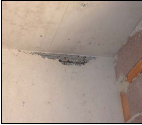
Şekil 4. Perde betonun iç yüzeyinde meydana gelen dökülmeler.
