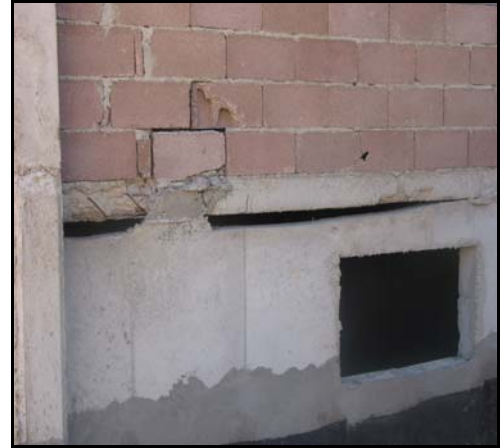
Şekil 3. Geleneksel sistemle üretilen bodrum kat uygulamasındaki derz açıklığı.
