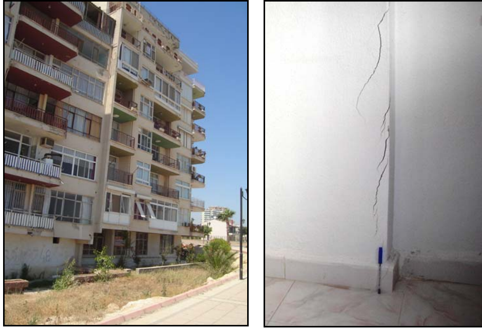
Şekil 9. Bölgedeki yapılarda meydana gelen yapısal hasarlardan bazıları (soldaki fotoğraf şakülden sapmış bir binaya aittir)
